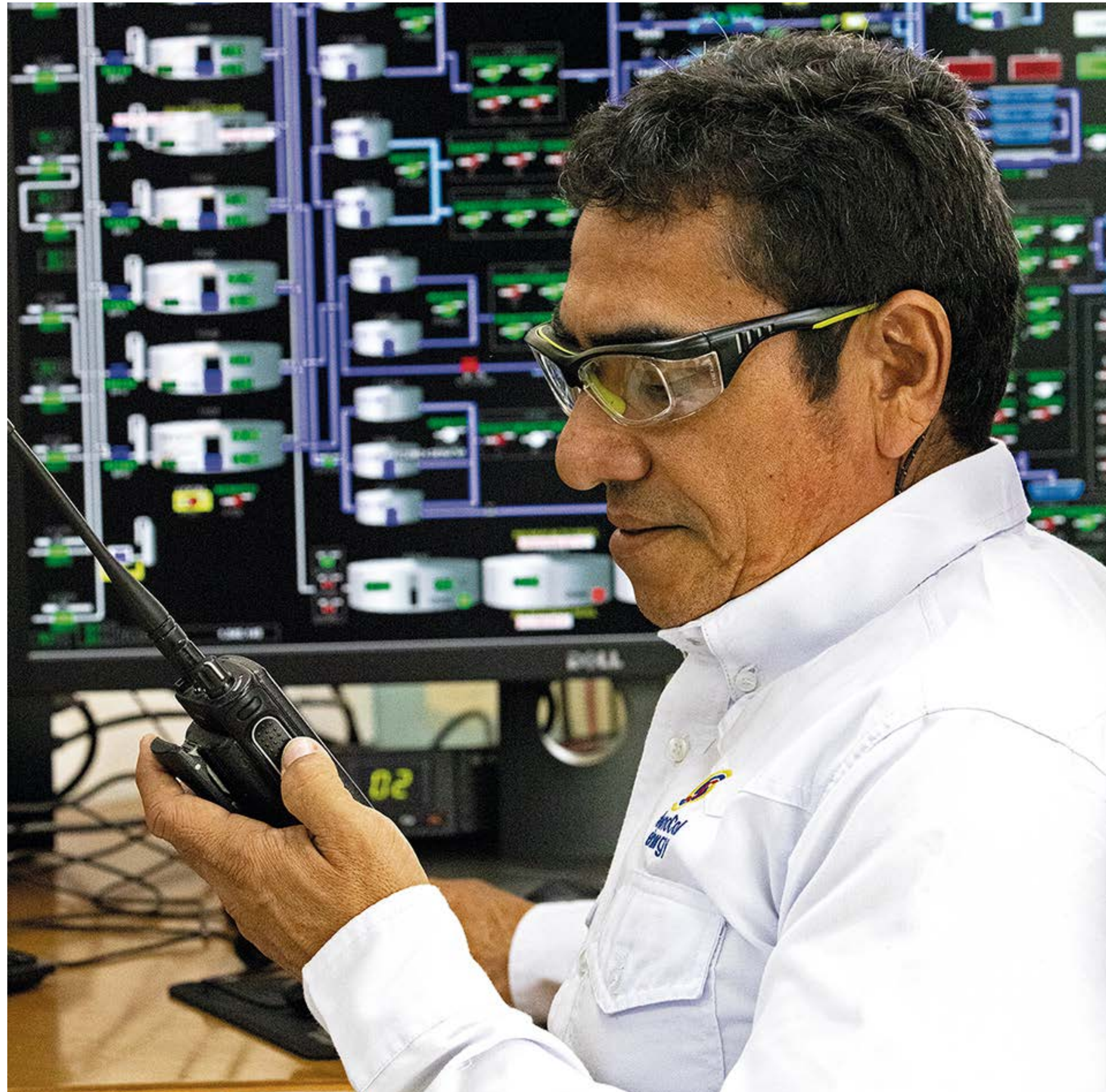
Cuarto de control, área de Caño Limón
