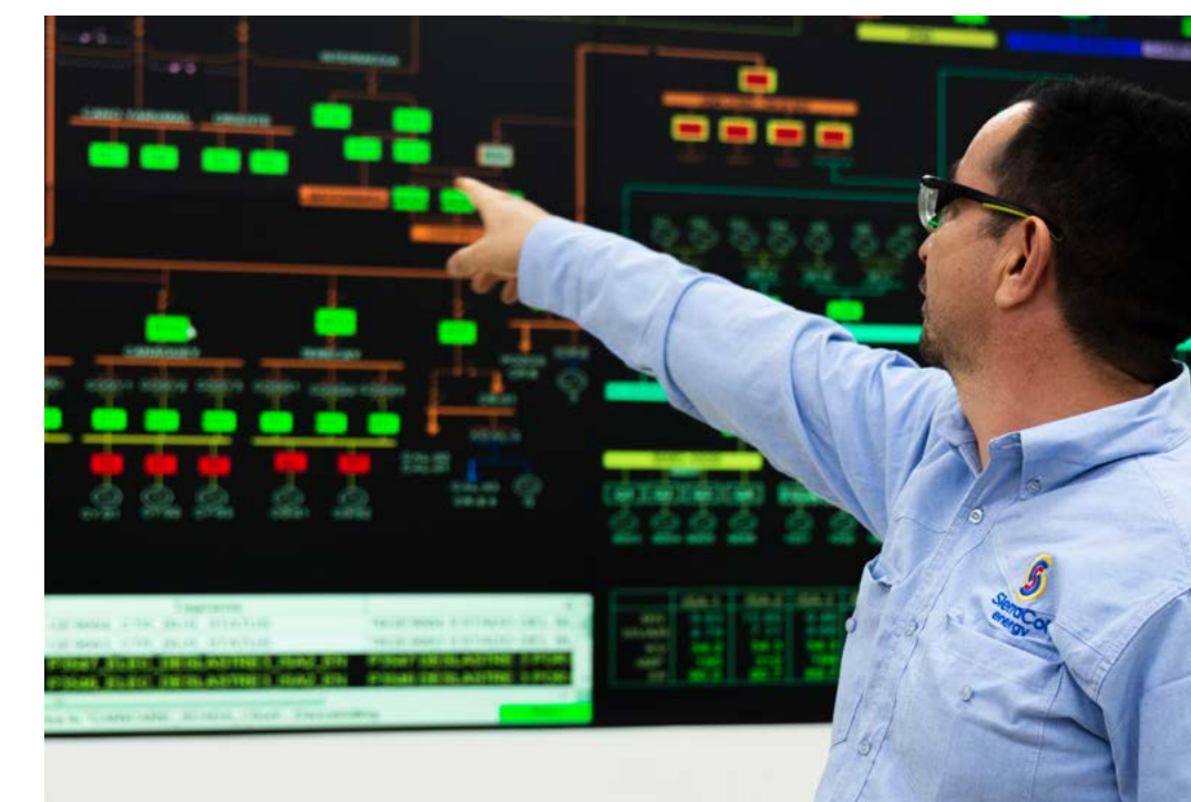
Cuarto de control, área de Caño Limón
