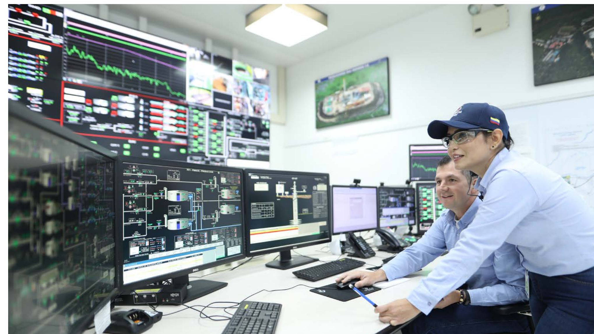
Cuarto de control, área de Caño Limón
