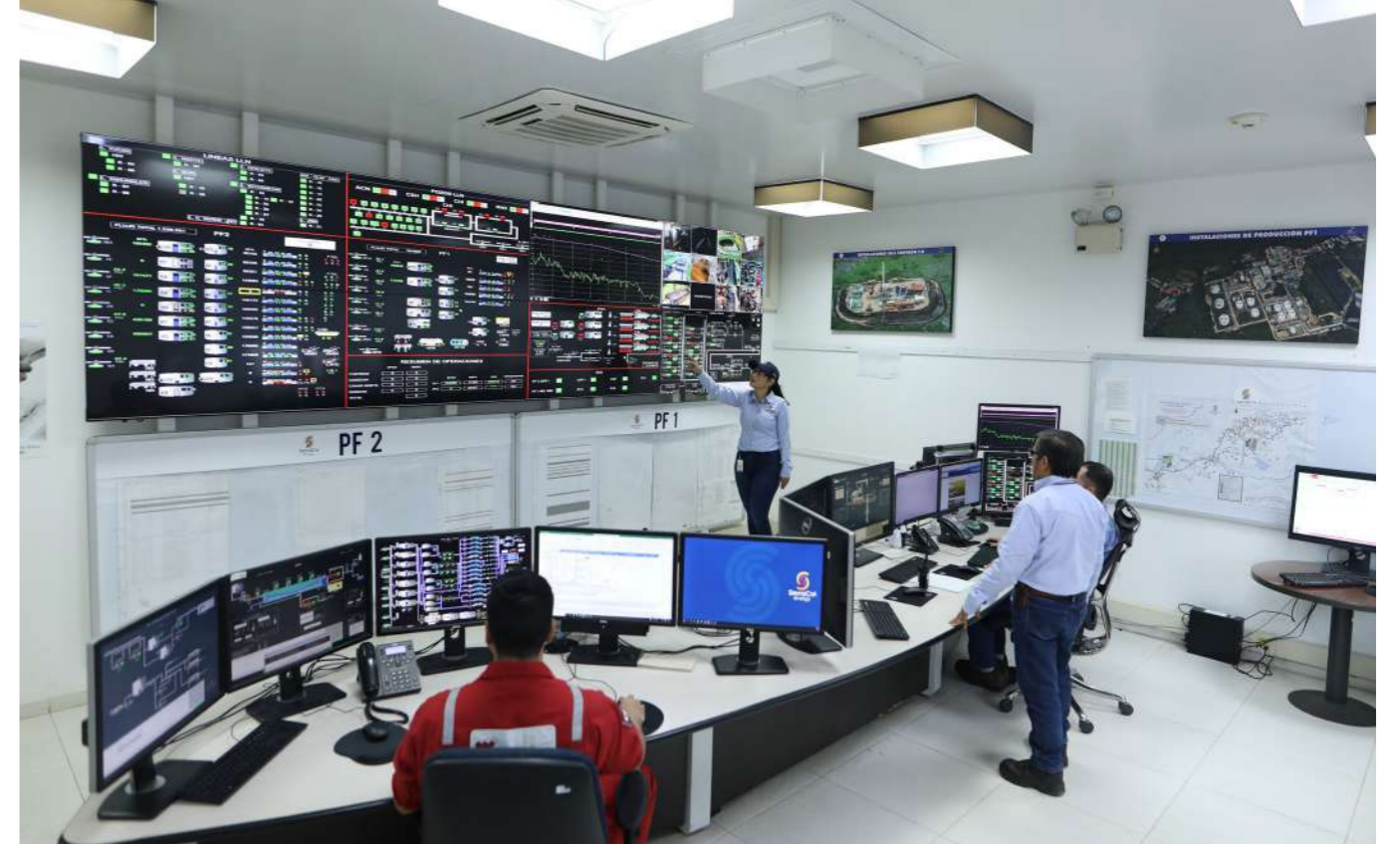
» Sala de control - Área de Caño Limón Arauca - Colombia
