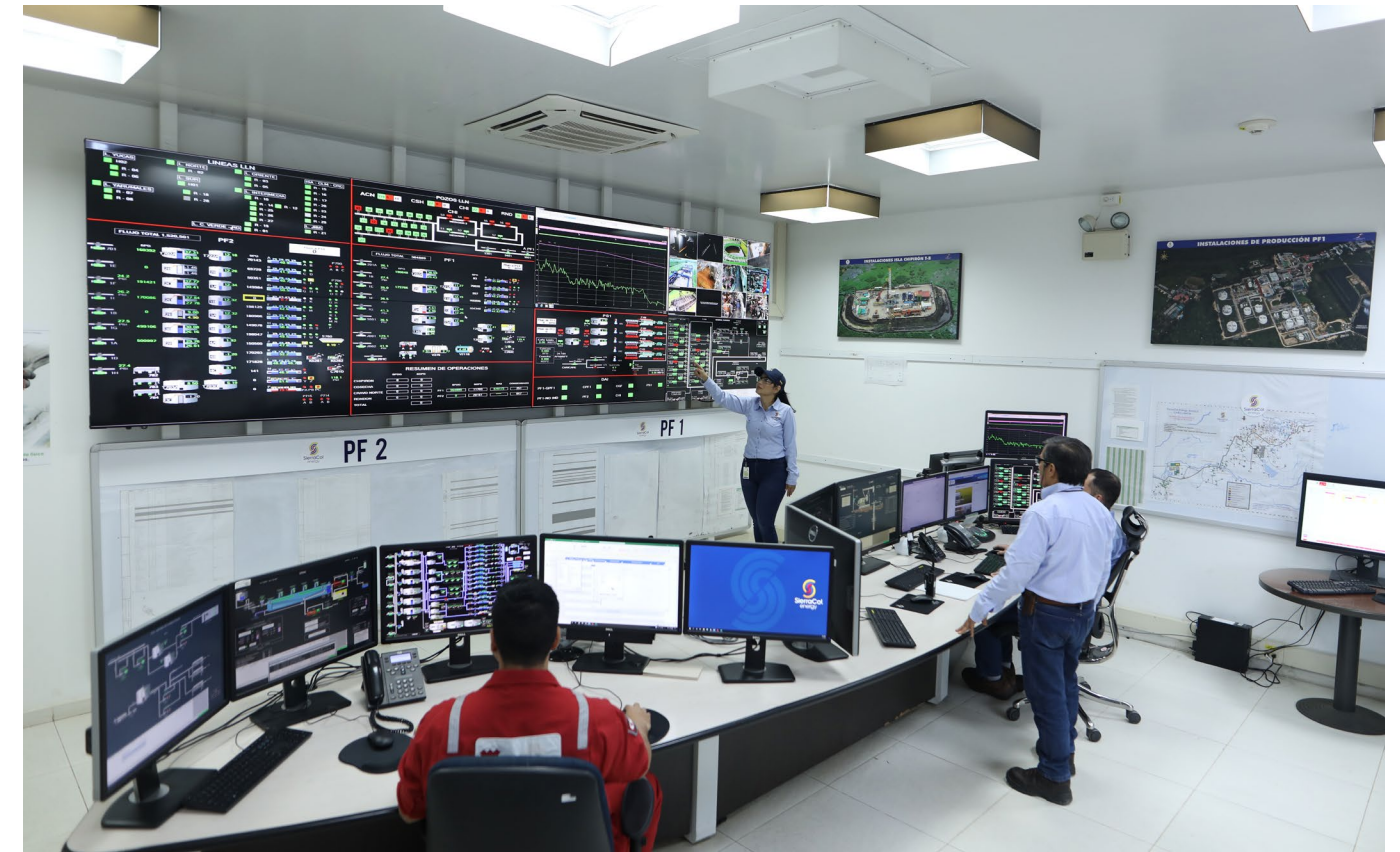
» Control room - Caño Limón area Arauca - Colombia
