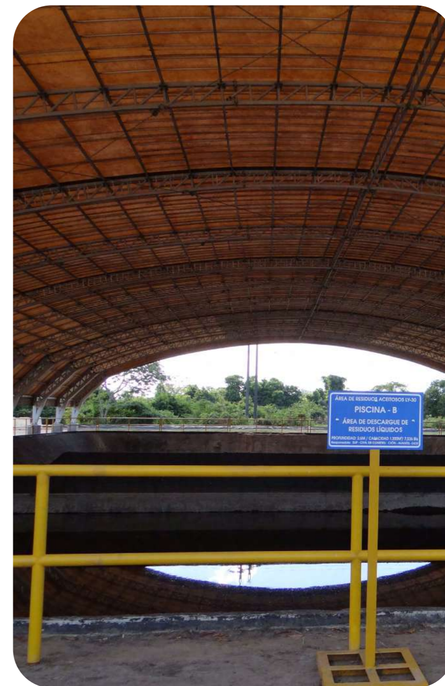
Planta de tratamiento de residuos aceitosos, Arauca
