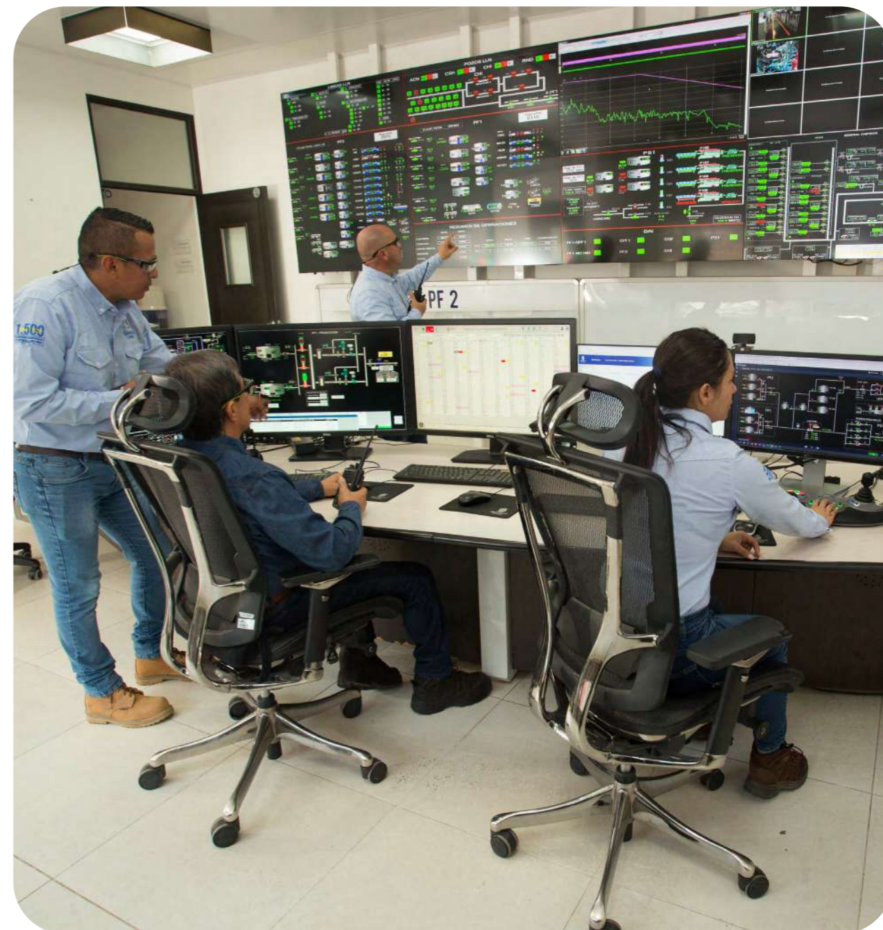
Sala de control, Arauca
