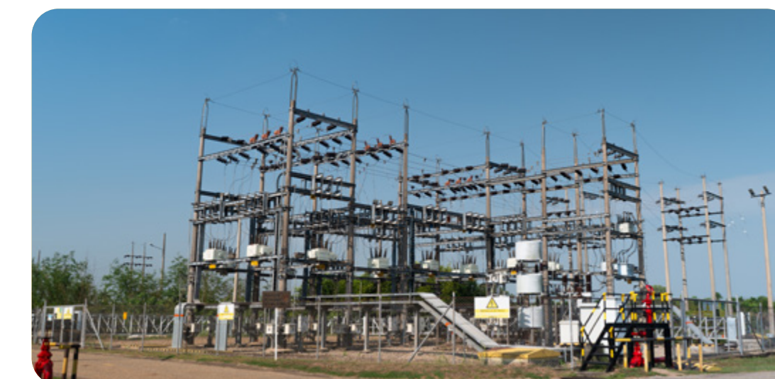
Subestación eléctrica, Llanos Central
