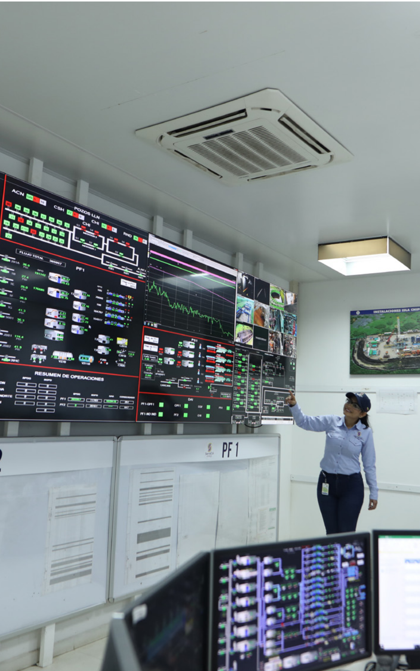
Cuarto de control, área de Caño Limón
