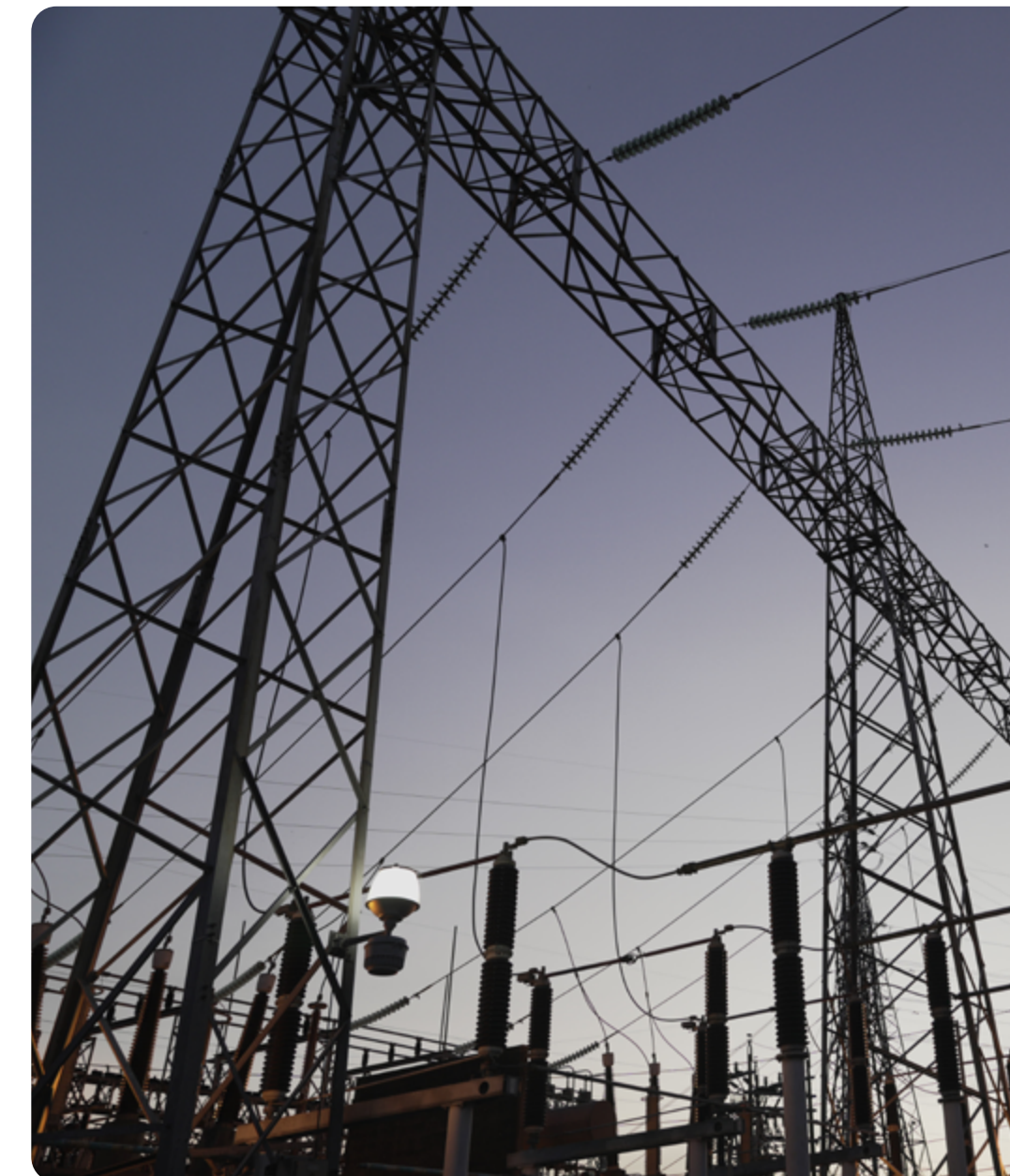
Subestación eléctrica, área de Caño Limón
